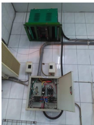
廚餘機配電設置
